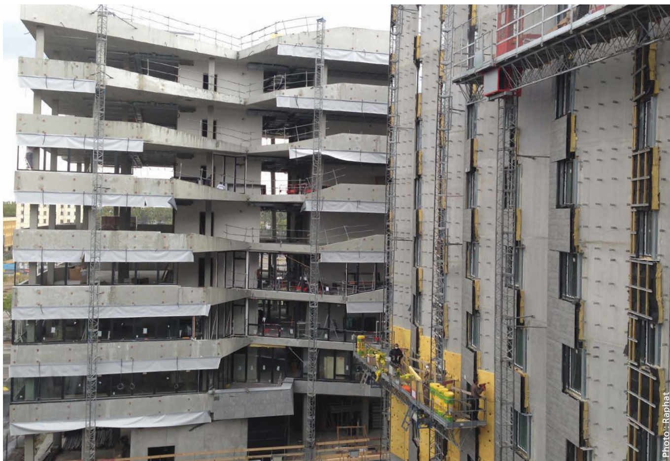
▲ Îlot Hikari à Lyon Confluence : toutes les chevilles et attaches de la structure secondaire du bardage sont isolées afin d'éviter tout pont thermique à ce niveau.
